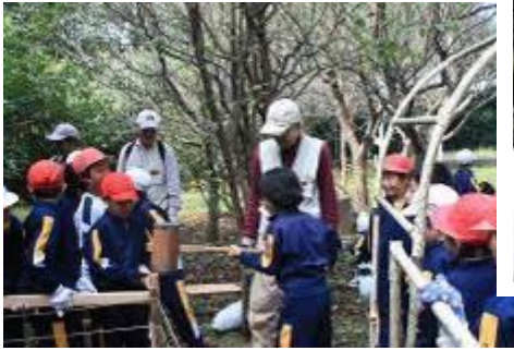
腐葉土を入れるための木枠の囲いづくり。くい打ち作業にも力が入る。
